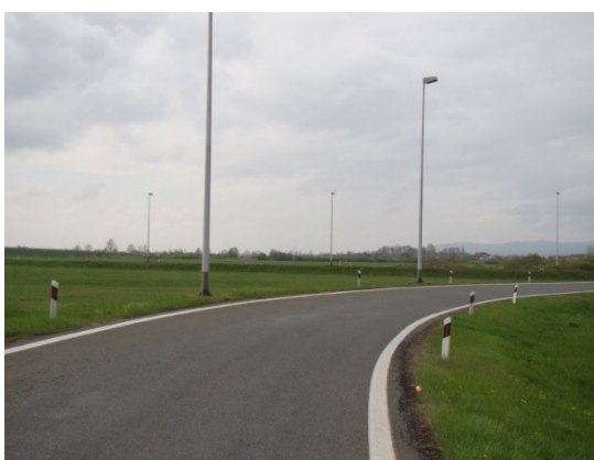
Slika 1. Izlaz sa autoputa koji bi mogao biti pasivno bezbjedan, da su bili upotrebljeni stubovi skladni sa EN-12767 tip 100HE3. Naknadno, prošle godine, zaštićeni su odbojnom ogradom.
