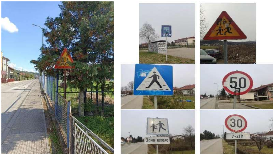
Slika 11. Primjeri slabo vidljive i oštećene vertikalne signalizacije (Autor)
