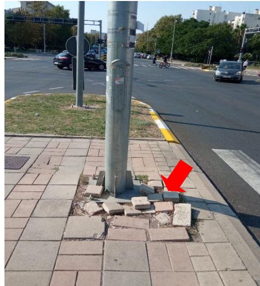
Slika 17. Oštećena površina trotoara
