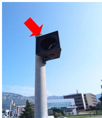
Slika 15. Oštećena lanterna semafora
