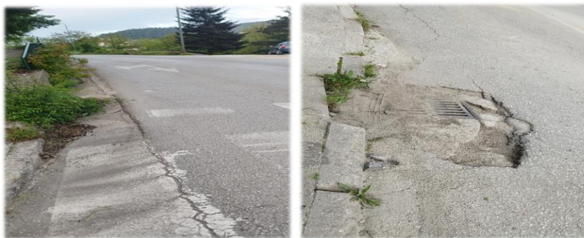
Slika 3. Trenutno stanje rigola i slivnika na GSP iz smjera Trebevića
